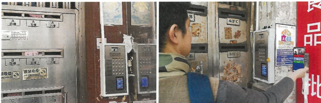
圖左：市建局為參與「聯廈聯管」的樓宇安裝「遠程管理系統」硬件裝置，包括圖中所示於地下出入閘門旁安裝智能對講機裝置，以便訪客到訪時可與住戶聯繫。
